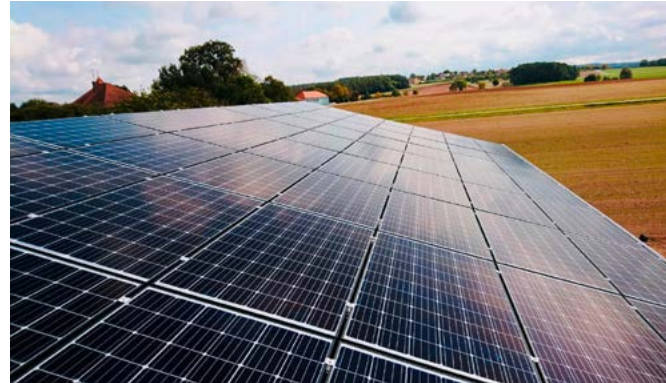
Die eigene Photovoltaikanlage gehört zum Nachhaltigkeitskonzept des Familienunternehmens.
